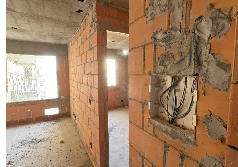
Fundo de Quadro – 6º Pav
