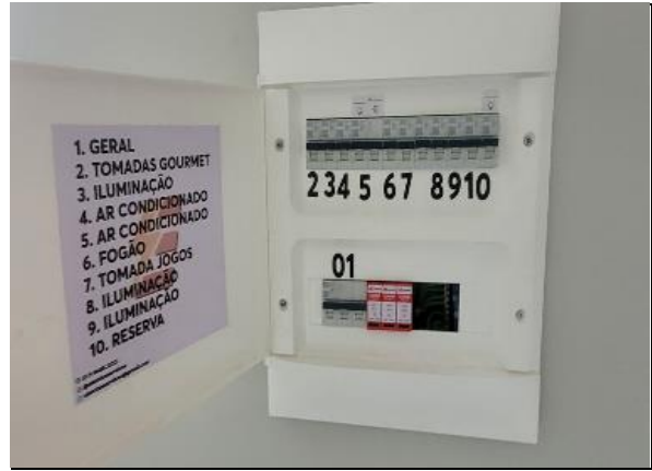
08 Quadro de distribuição de energia
