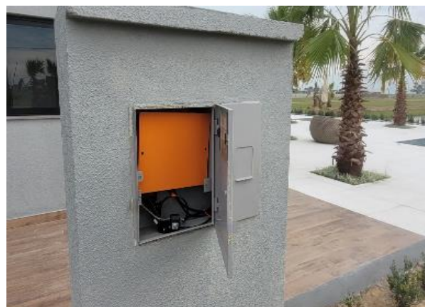
12 Quadro de Medição de Energia - Salão de Festas.
