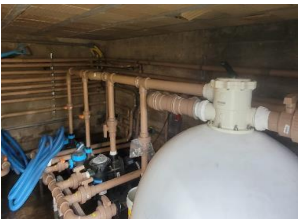
11 Filtros e Bombas - Piscina.
