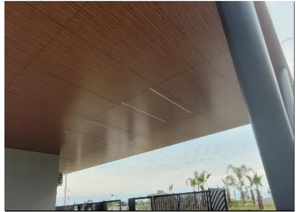
02 Forro e Luminárias - Pórtico.
