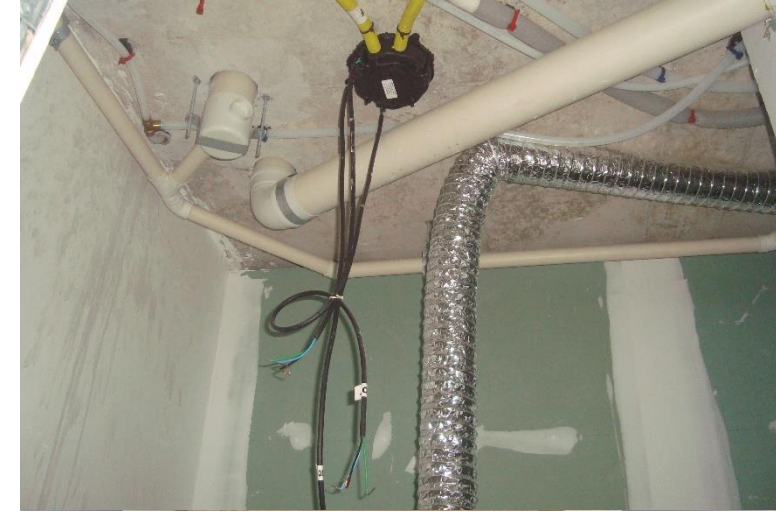
Cabos Elétricos – 4º Pav
