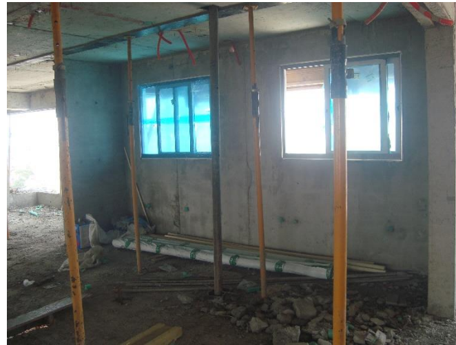
Esquadrias de Alumínio – 21° pav
