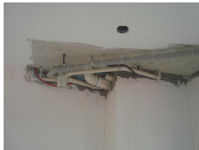
Prumadas de Esgoto – 2° Pav
