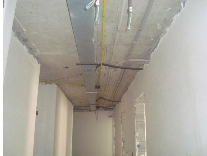
Eletrocalhas – 7º Pav
