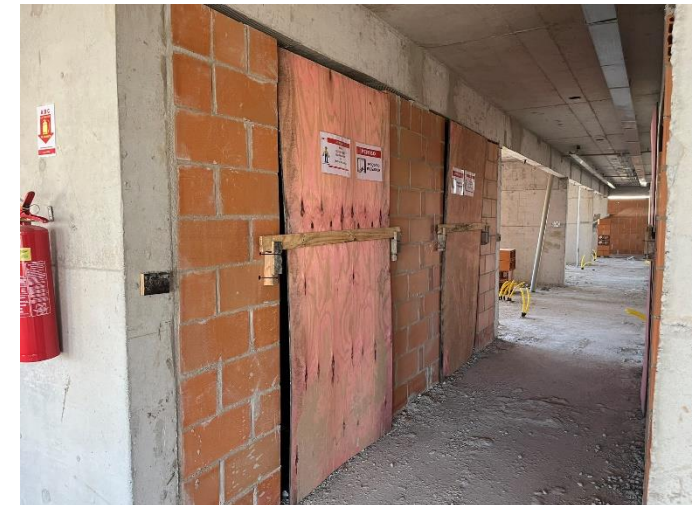
Proteções de Vãos dos Elevadores
