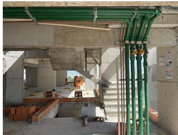
Prumada Hidráulica – 16º Pav
