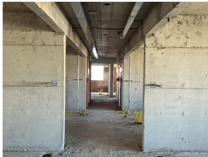
Eletrocalhas – 11º Pav
