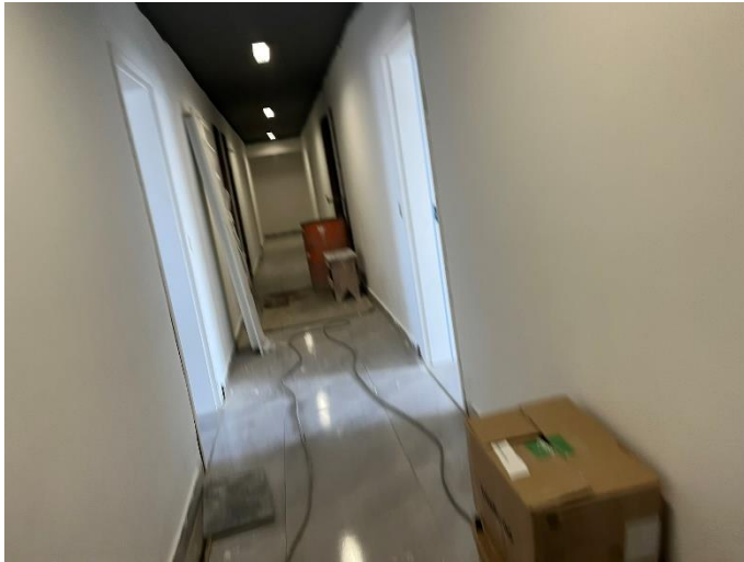
Luminárias – 18º Pav
