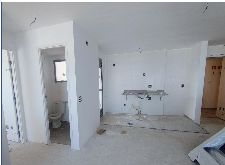
Foto 13 – Bancadas e módulos de tomadas e interruptores – 21º pavimento
