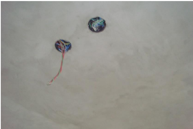
Cabos de Instalações – 2º Pav
