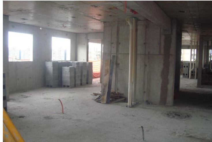
Prumada Hidráulica – 3º pav
