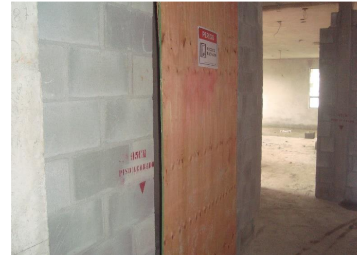
Proteção de Vão de Elevador
