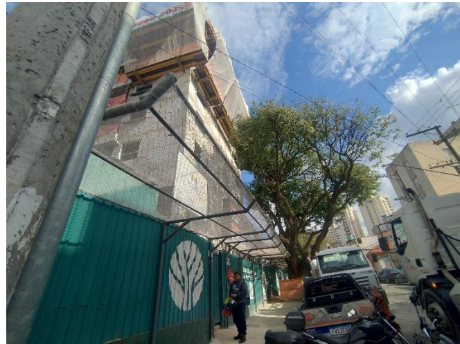
Proteção Passagem de Pedestre
