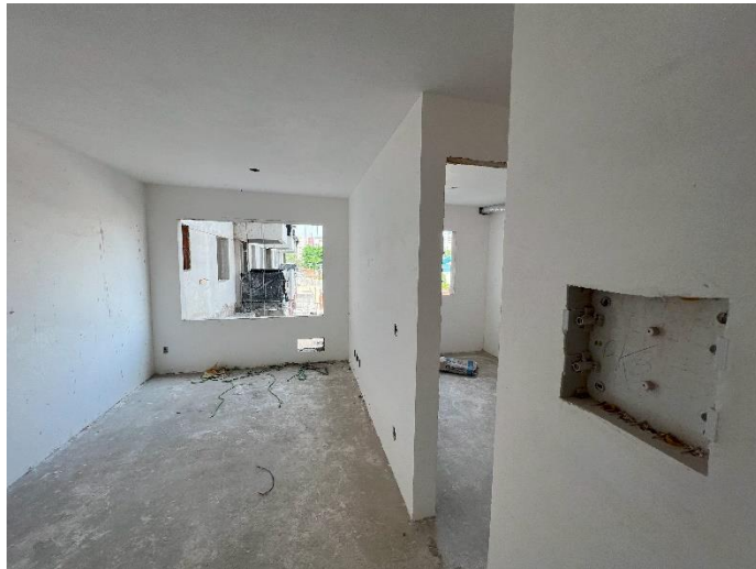
Fundo de Quadro – 5º Pav
