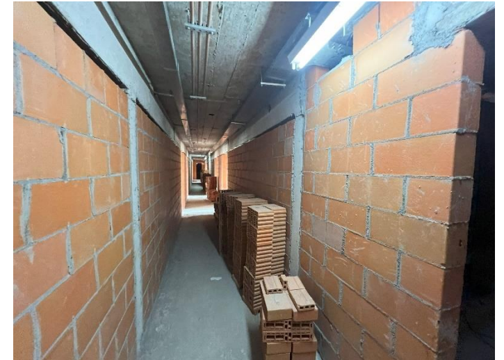
Eletrocalhas – 15º Pav
