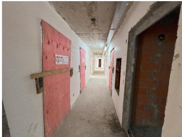
Proteções Vãos dos Elevadores
