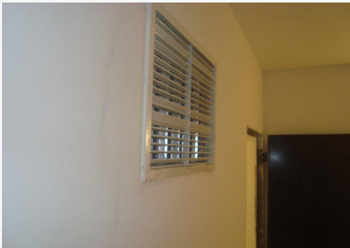
Grelha de Pressurização – 9º Pav
