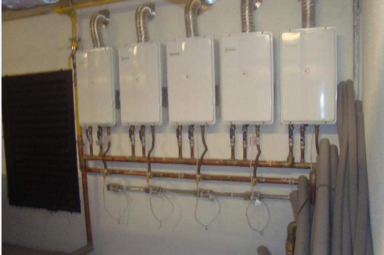
Sistema de Aquecimento Central – 20º Pav
