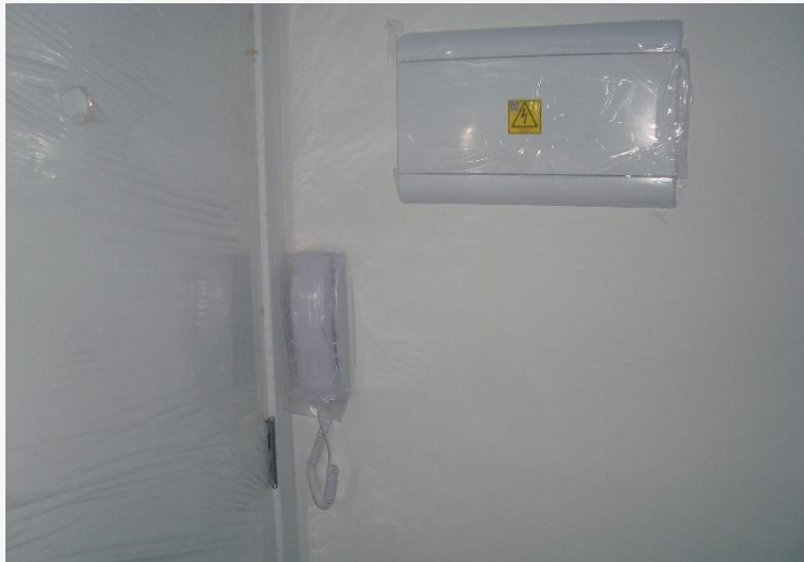
Quadro Elétrico e Interfone – 13º Pav
