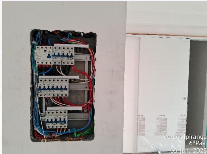
Disjuntores – 6º Pav.
