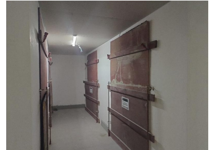
Proteção de Vãos de Elevadores
