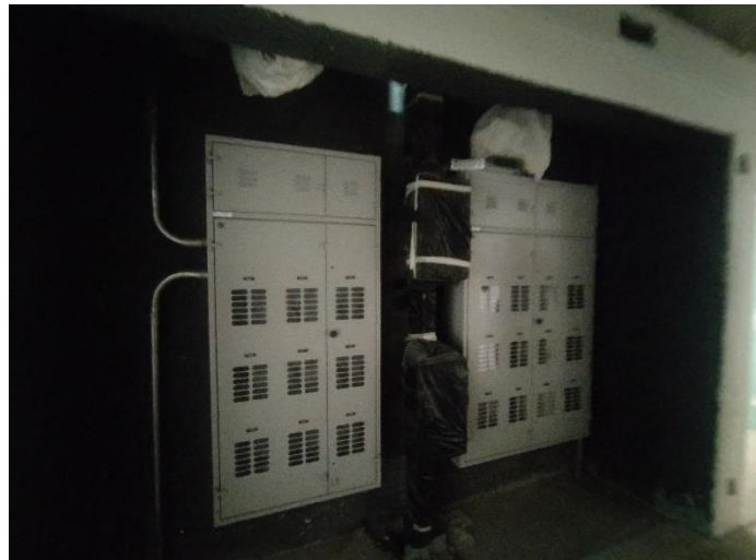
Caixas Busway – 19º Pav
