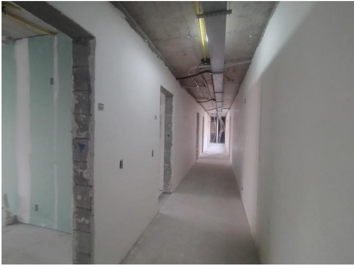
Eletrocalhas – 11º Pav
