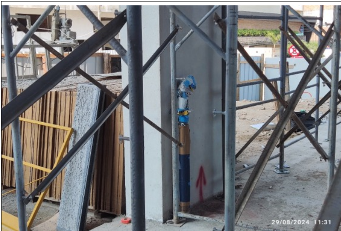
Foto 38 – Ponto de hidrante na recepção
