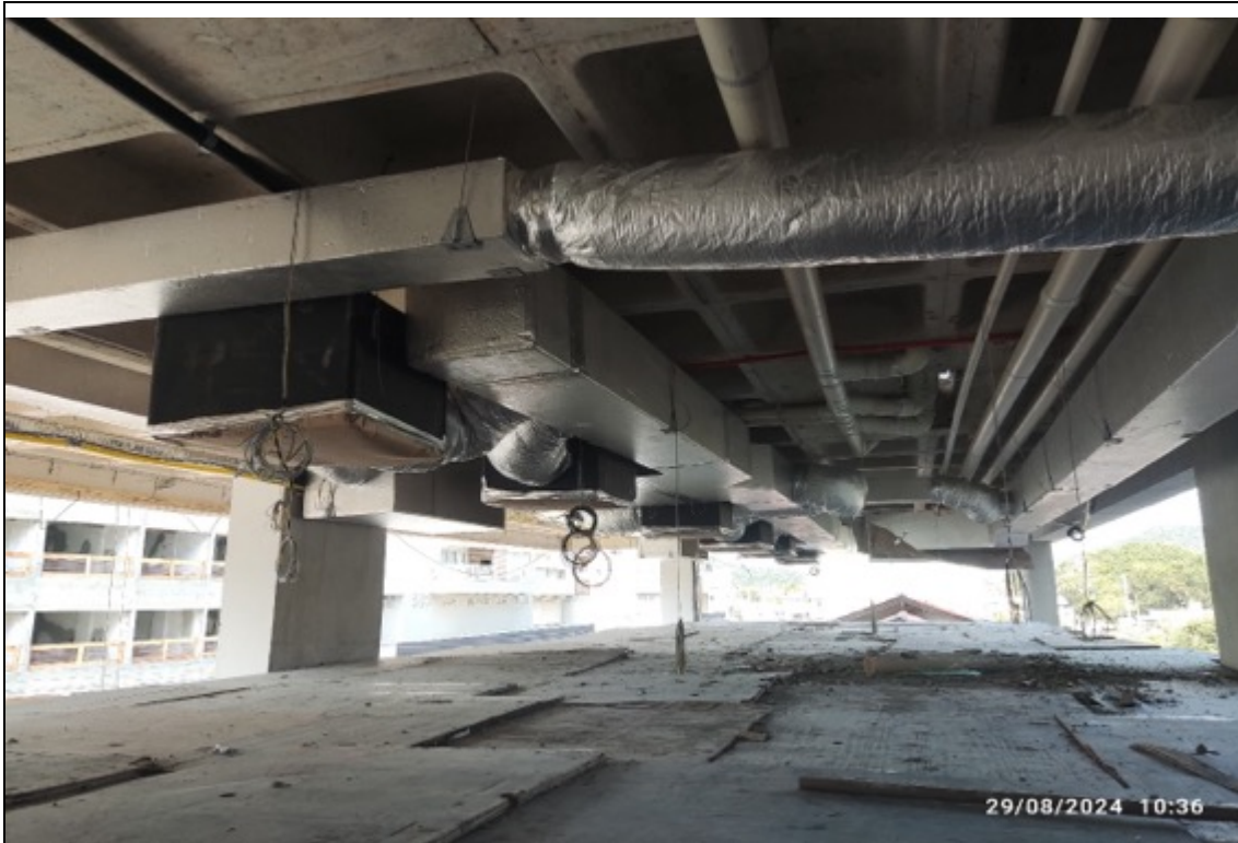
Foto 1 – Ar-condicionado da recepção do hotel
