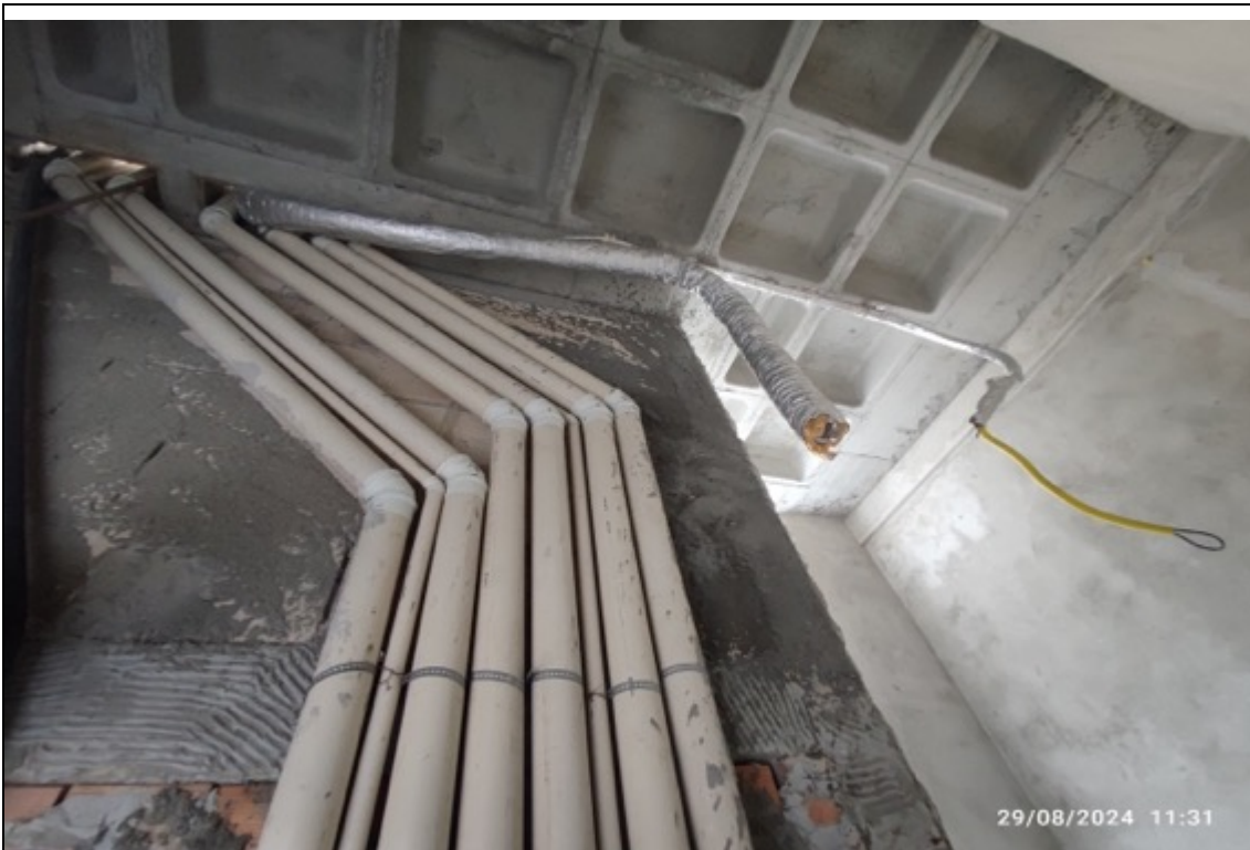
Foto 36 – Desvio de hidráulica no térreo
