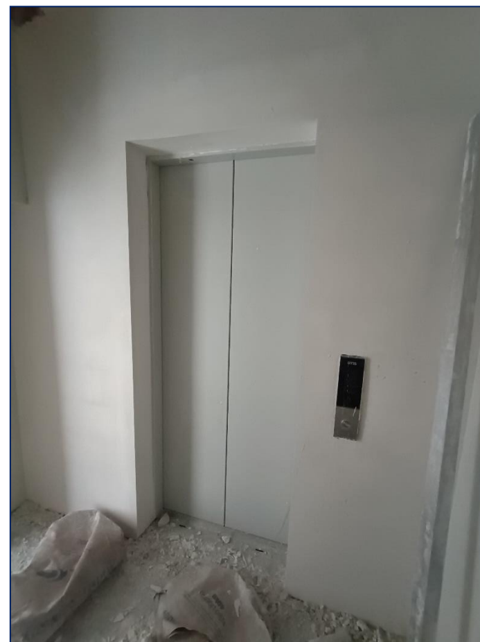
Foto 8 - Elevador de serviço - 19º pav
