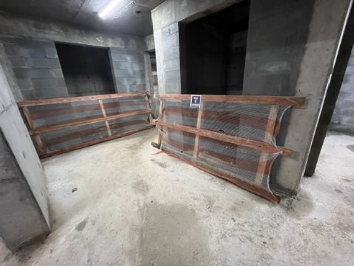
Proteção em vão de elevadores
