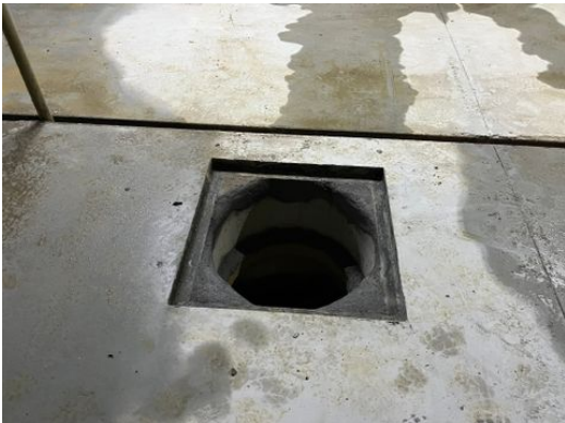
Caixa integrante do sistema de drenagem do 3.º subsolo
