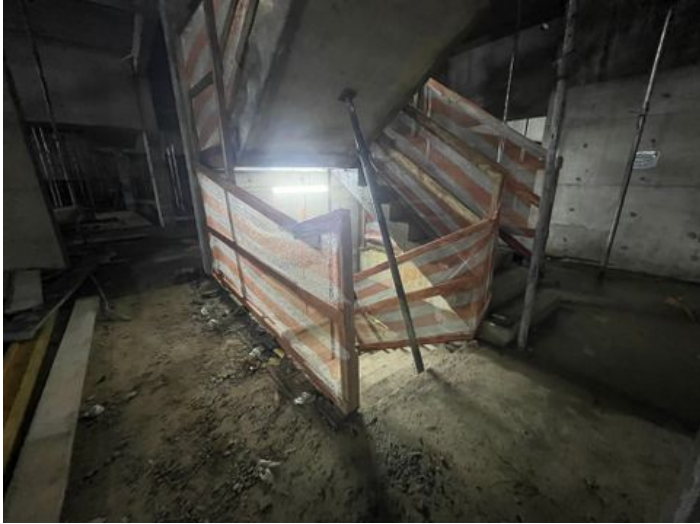
Vãos de escadas protegidos
