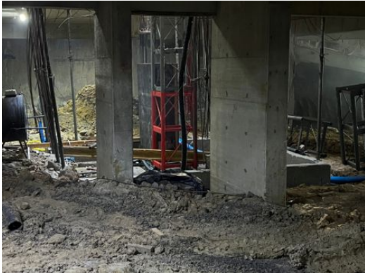
Base da Grua, no 3.º subsolo
