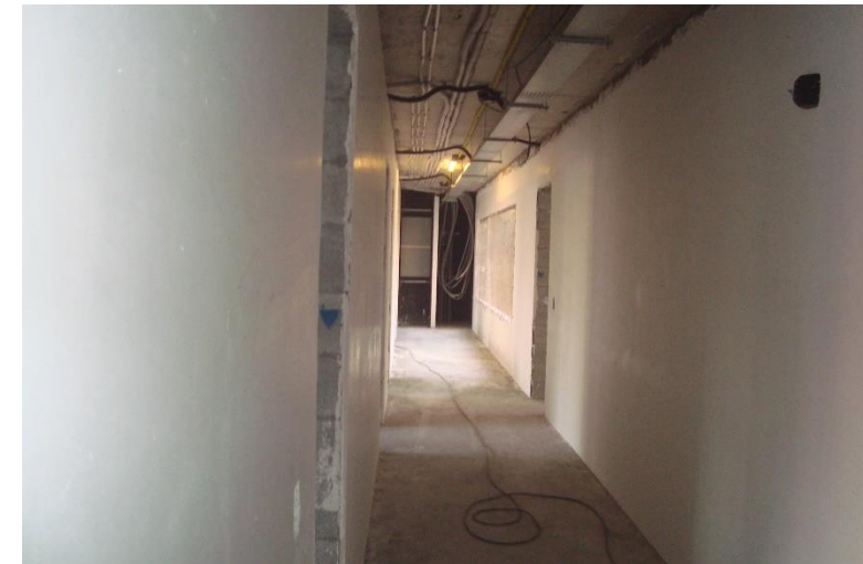
Eletrocalhas – 10º Pav
