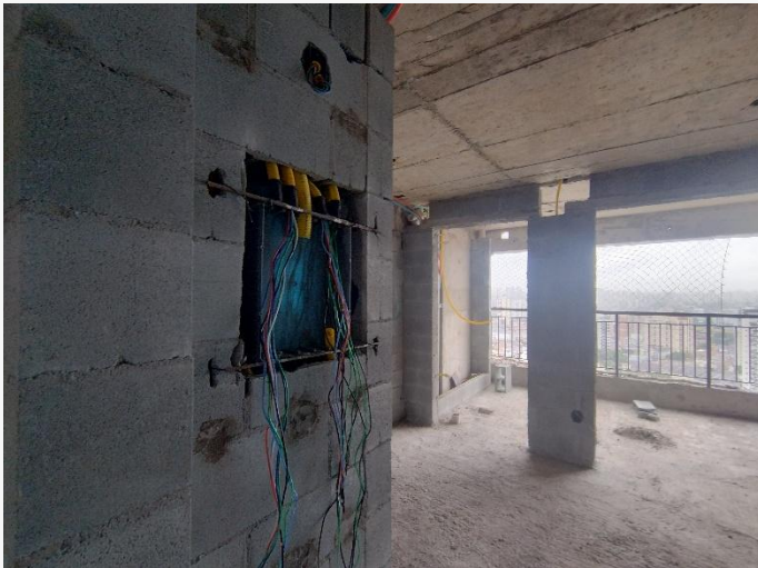
Cabos de Instalação – 22° Pav
