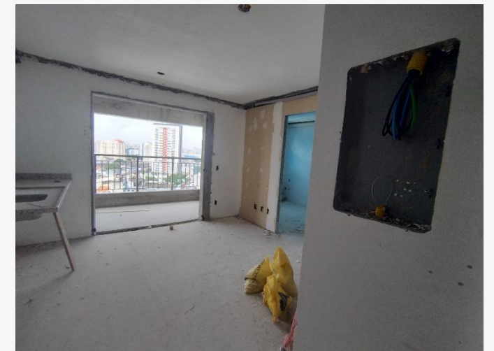
Fundo de Quadro – 7º Pav
