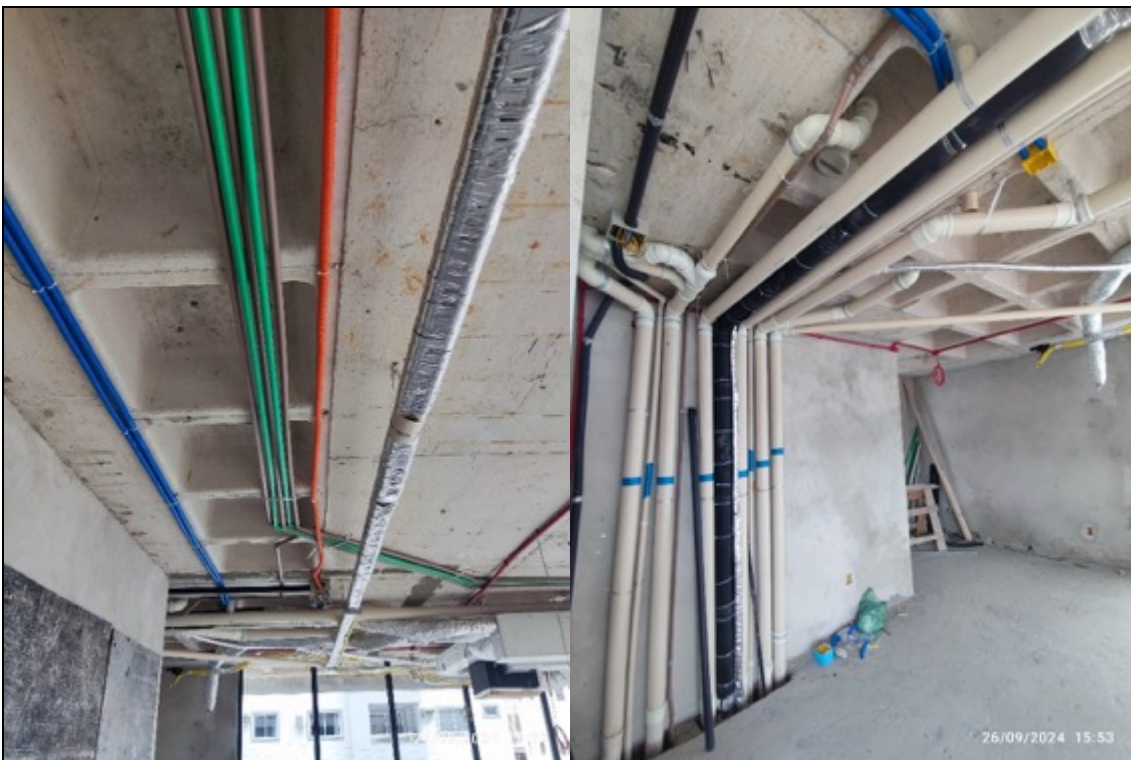
Foto 4 – Hidráulica aérea da recepção
