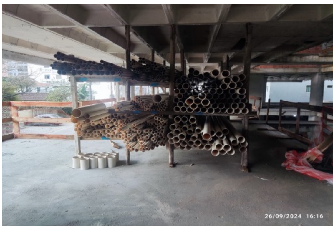
Foto 14 – Estoque de tubos e conexões
