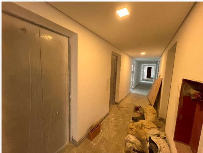
Luminárias – 8º Pav.
