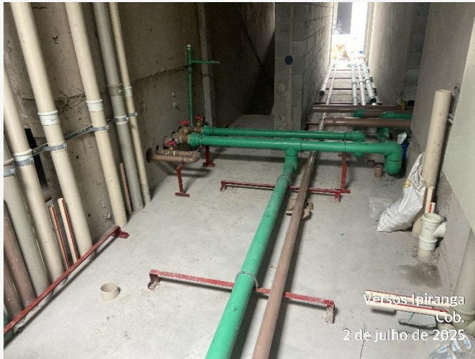
Barrilete Hidráulico – Cobertura
