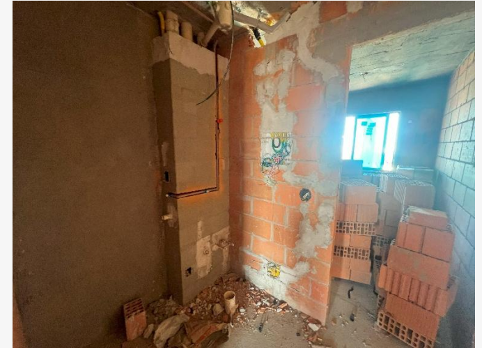
Cabos de Instalações – 16º Pav
