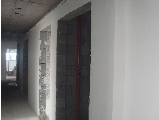
Prumada de Incêndio – 15° pav
